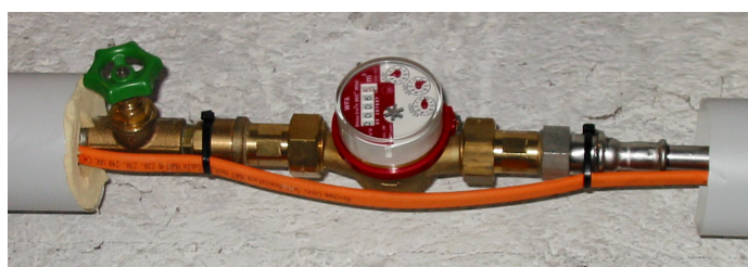
Fig. 5 : Une telle disposition crée un « bouchon de froid » et entraîne de grandes pertes thermiques malgré la présence du ruban chauffant. L'isolant devrait être continu et ne laisser que deux petites ouvertures, l'une pour la vanne et l'autre pour l'écran du compteur. Photo : J. Nijpkow
